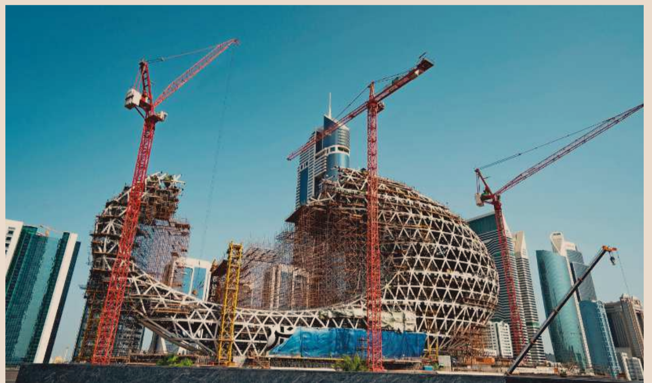
Le Musée du futur, en construction, illustre la volonté de Dubaï d'être toujours «10 ou 20 ans en avance». © IAIN MASTERTON
